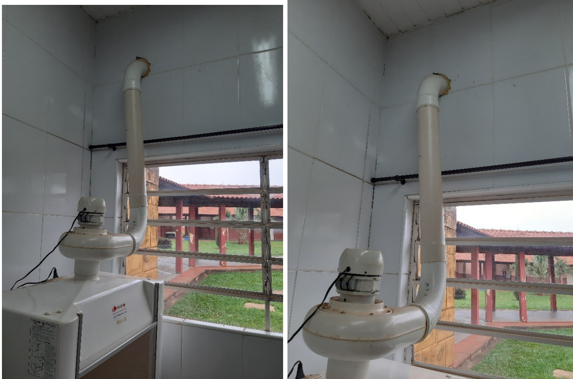
Foto 02 – Local para abertura e Instalação correta da Capela
